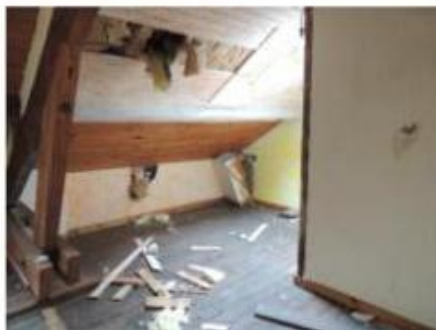
Etat intérieur de l'immeuble
