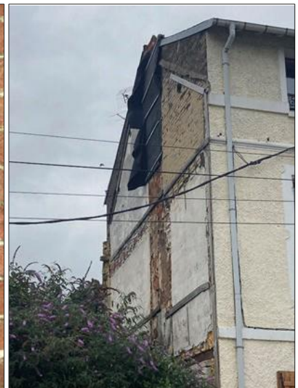
Photo 4 - 10 Quai d'aval (Creil) Pignon à protéger par de l'ardoise naturelle de teinte claire ou des tuiles à la chaux.
