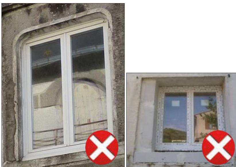
Photo 16 Pose de menuiserie à proscrire car inadaptée à la baie
