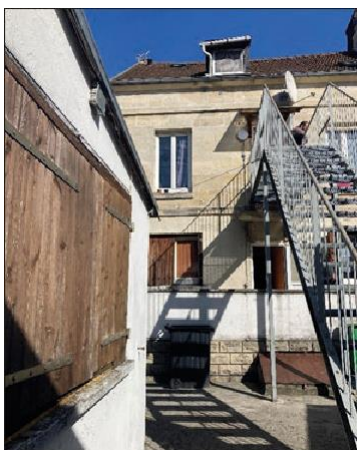
Photo 19 : 15-17 rue Louis Lebrun (Creil) : escalier non sécurisé / absence de garde-corps aux fenêtres
