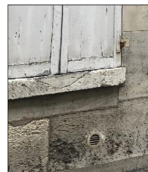
Zoom sur appuis fissurés
