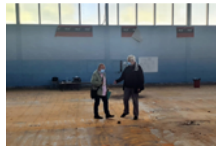
Jean-Claude Cabaret, conseiller municipal chargé de la gestion du patrimoine communal, s'assure de la bonne tenue du chantier du gymnase.
