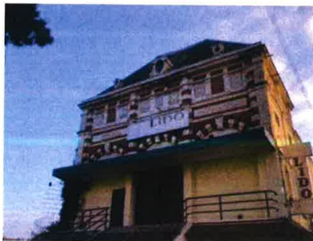
Enseigne parallèle au mur installée en étage et masquant les modénatures du bâtiment, mars 2021, Creil.
